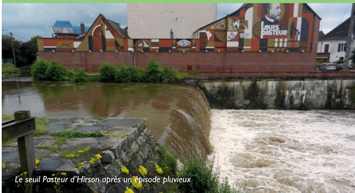
Seuil Pasteur avec le débit du Gland passant par le seuil annexe
