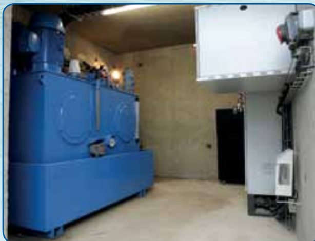
La centrale à huile du site de Proisy
