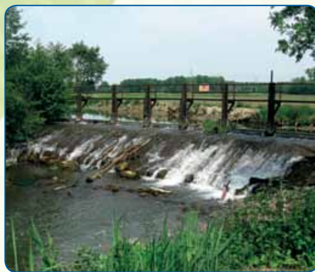
Projet d'étude pour rétablissement de la continuité écologique et sédimentaire de l'ouvrage « grenelle » de Chauny
