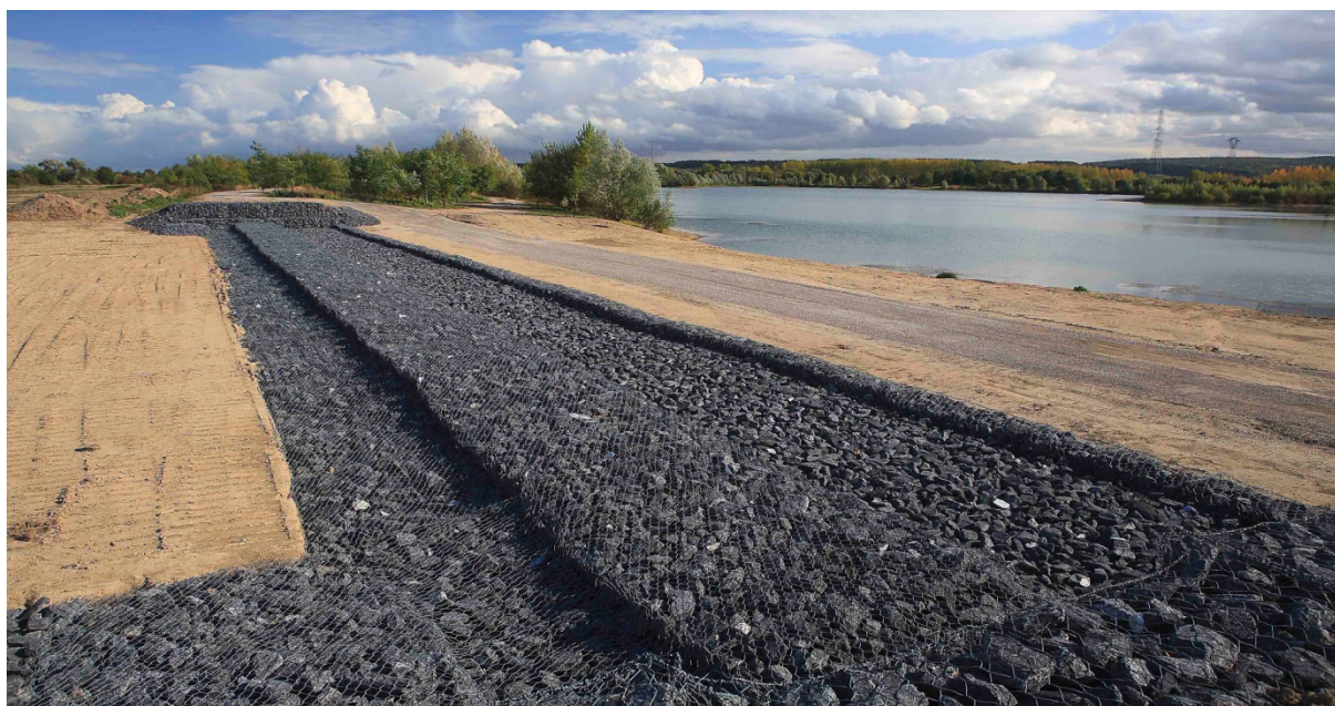
Déversoir à Pont-Sainte-Maxence (60) permettant l'alimentation contrôlée d'étangs convertis en réserve écologique par l'Entente Oise Aisne.
