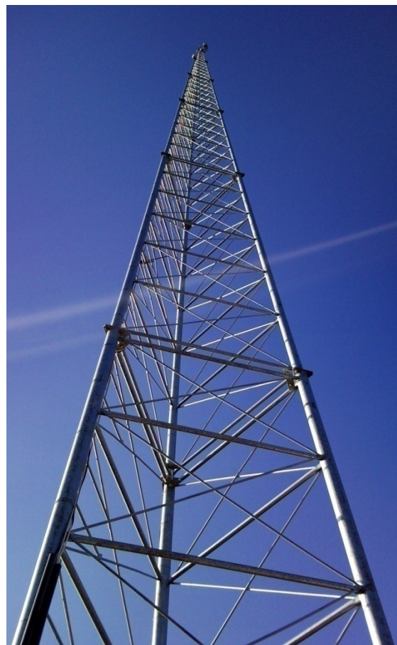
Mât de 36 m à Chevrières, au poste de commande du vaste dispositif de Longueil-Sainte-Marie. Il permet une télégestion des vannes et une surveillance centralisée des niveaux.
