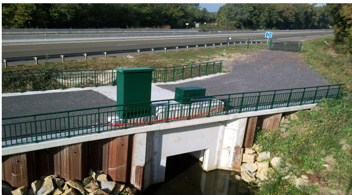
Vanne motorisée permettant de réguler les plans d'eau, à Longueil-Sainte-Marie (60).
