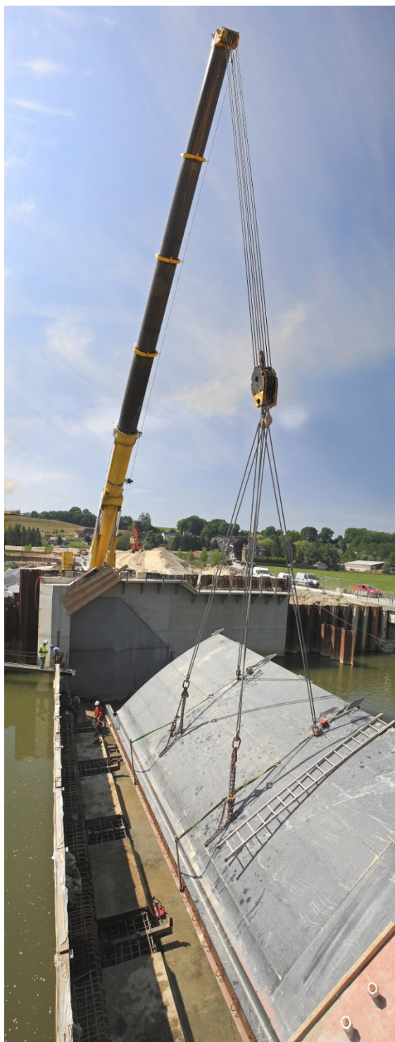
Clapet de Proisy en position.
