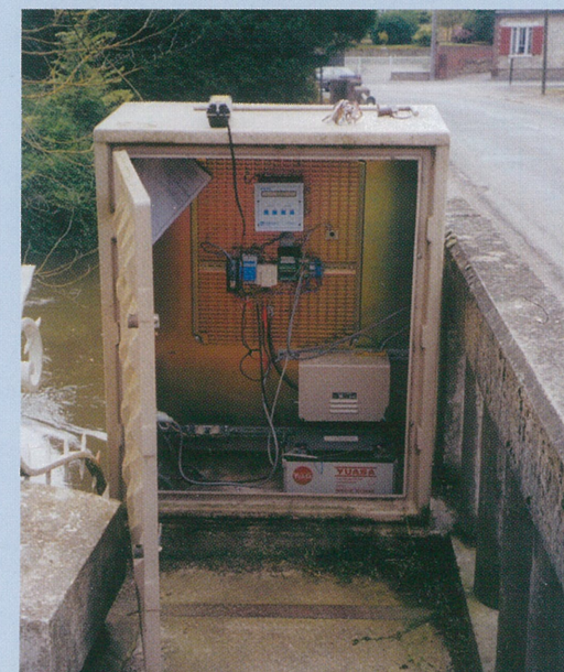
STATION DE MESUR
