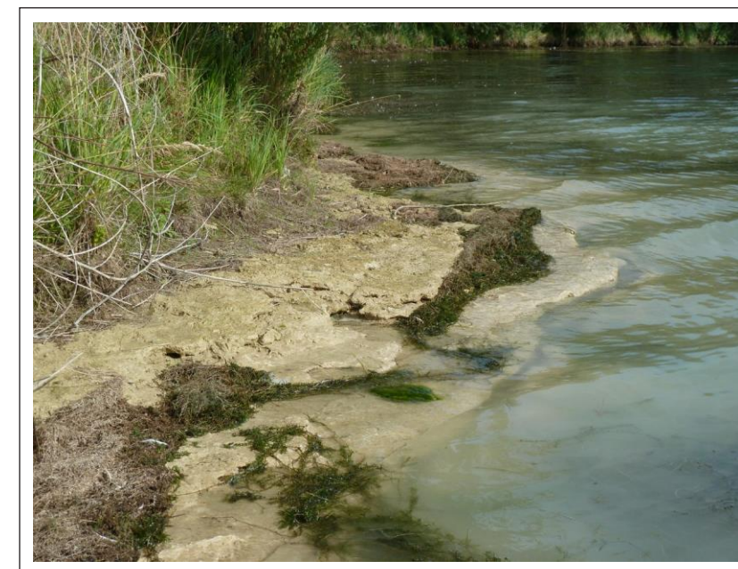
PHOTO 32 : BERGE ERODEE ET PEU VEGETALISEE
