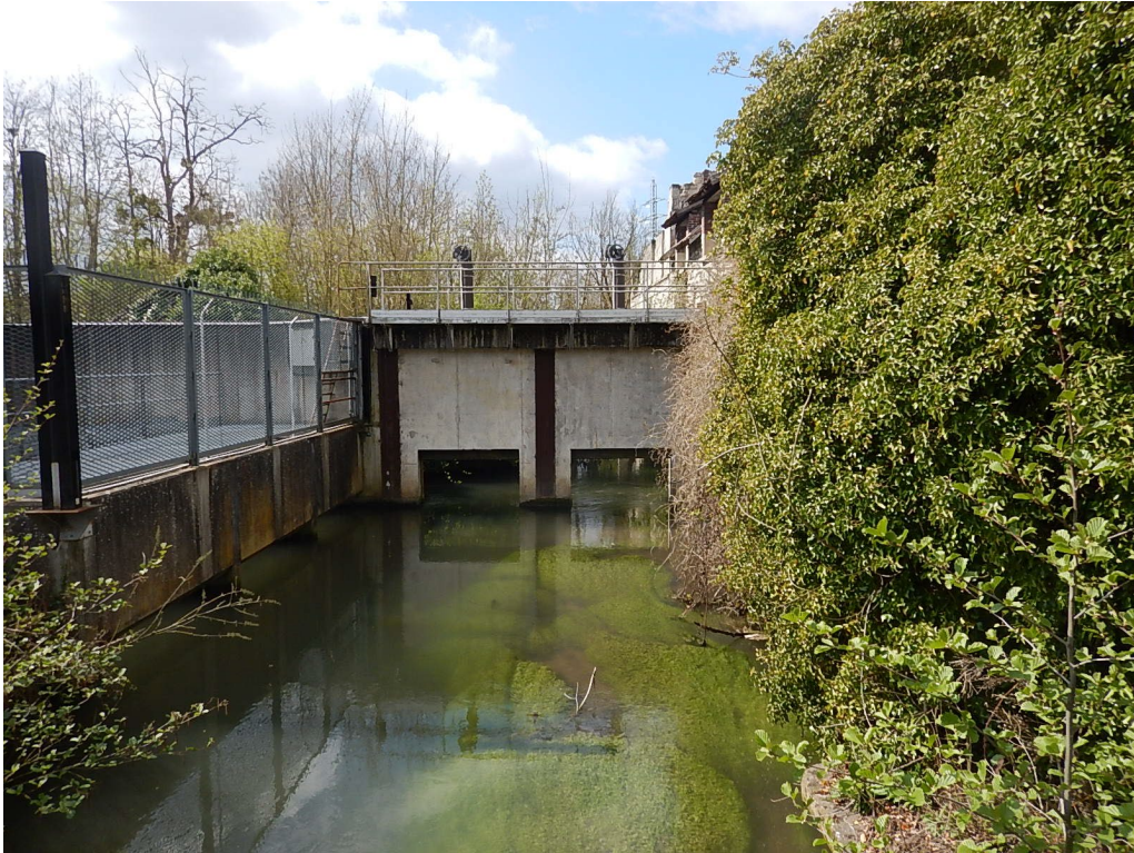
Figure 5-7 : Photo du poste de relevage au droit de l'Aronde, détail de vannes (Source : hydratec)
