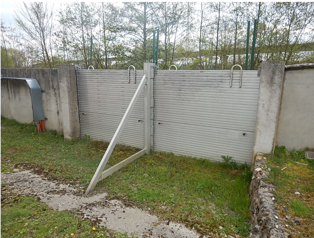
Figure 5-11 : Photo du tronçon 4 du système d'endiguement de Clairoix, détail du système de batardeaux (Source : hydratec)
